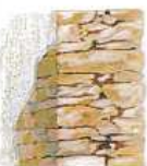
mur ancien non ou peu isolé à la terre, enduit à la chaux, crépis ou crépis au plâtre
